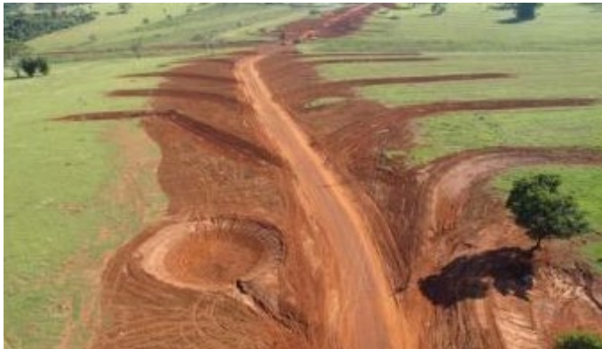
Figura 55 - Vista aérea de “bigode” e bacia de captação de água de chuva (“barraginhas”), em obra na bacia do Rio Verde Grande (MG)
